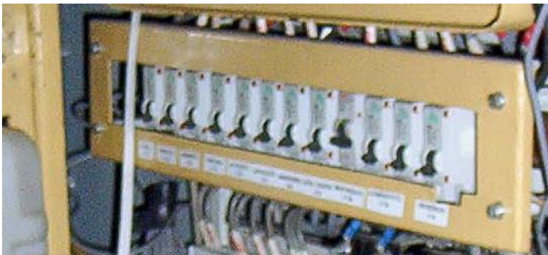
56. ábra. vezetékvédő automaták a jobboldali készülékszékényben „A”
