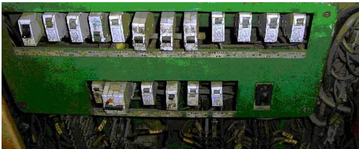
57. ábra. vezetékvédő automaták a jobboldali készülékszékényben
